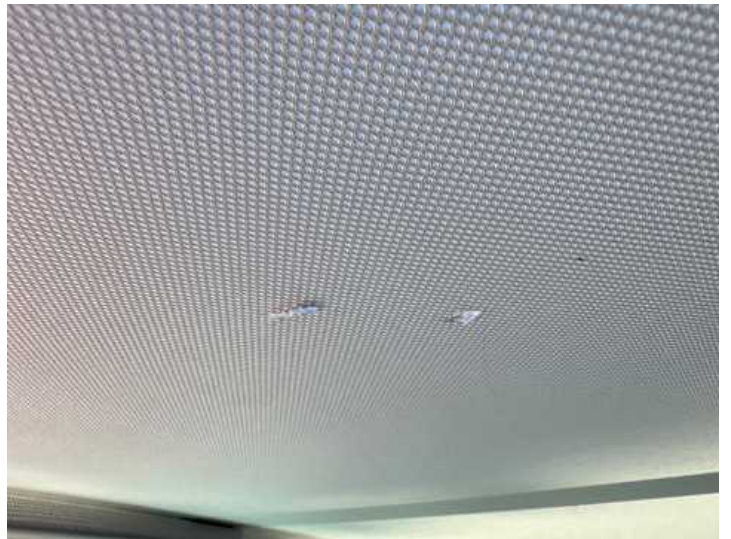
Innenraum (Riss/Bruch, Verschmutzung)
