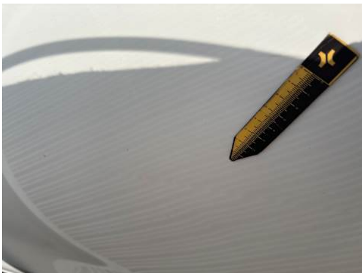
Türe hinten rechts (Verformung)
