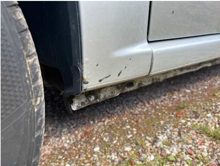
Kotflügel vorne links (Rost)
