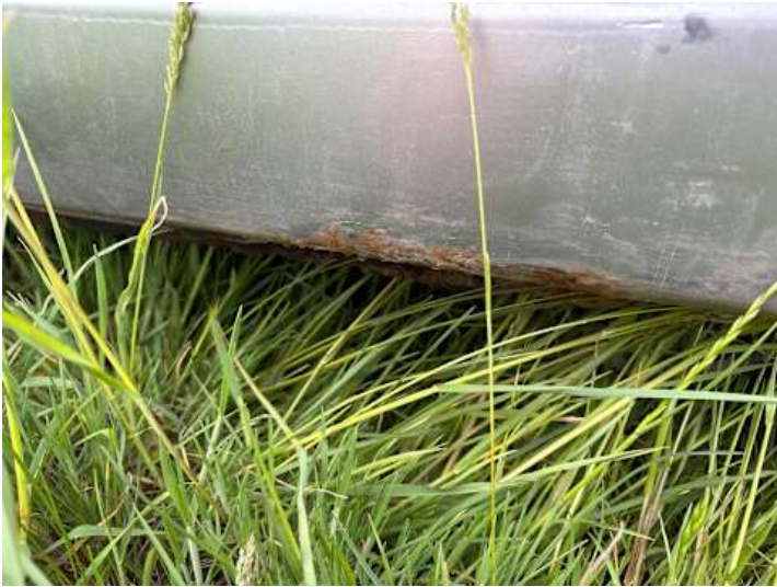
Schweller links (Rost)
