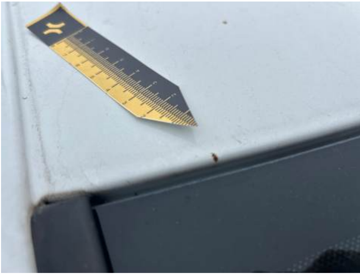
Dach (Steinschlag, Rost)
