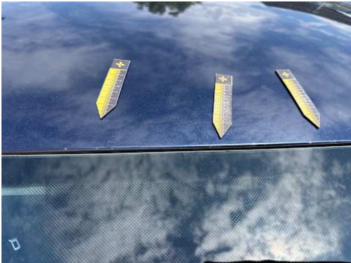
Dach (Steinschlag, Rost)
