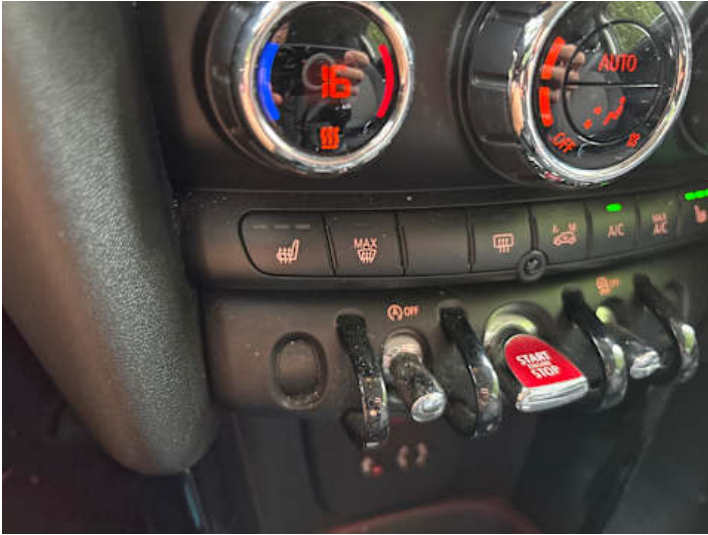
Innenraum (Anderer Schaden): Fahrersitzheizung ohne Funktion
