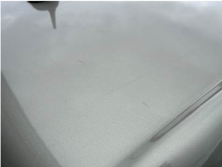
Dach (Delle, Kratzer, Rost)
