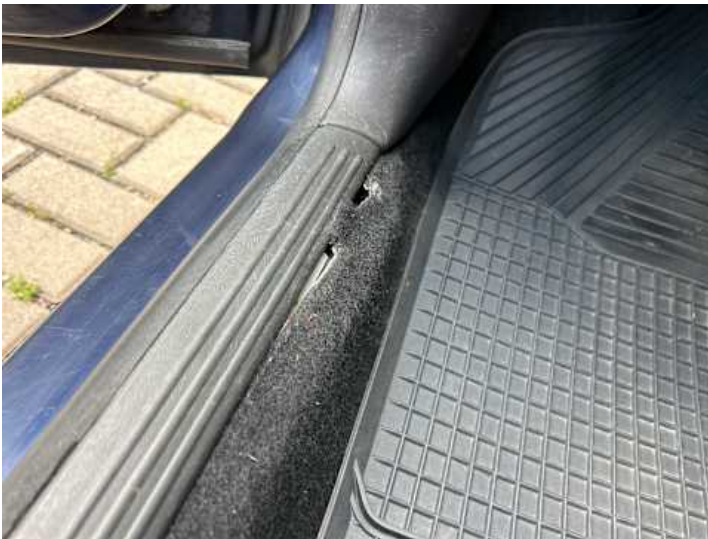
Innenraum (Diverse Schäden, Verschleiß)
