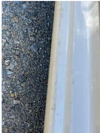
Schweller links (Delle, Kratzer)
