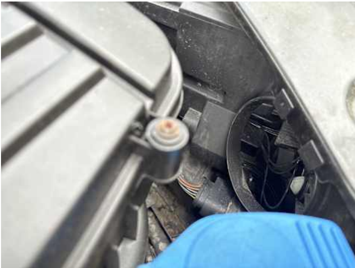
Scheinwerfer (links) (Anderer Schaden): Abdeckung fehlt
