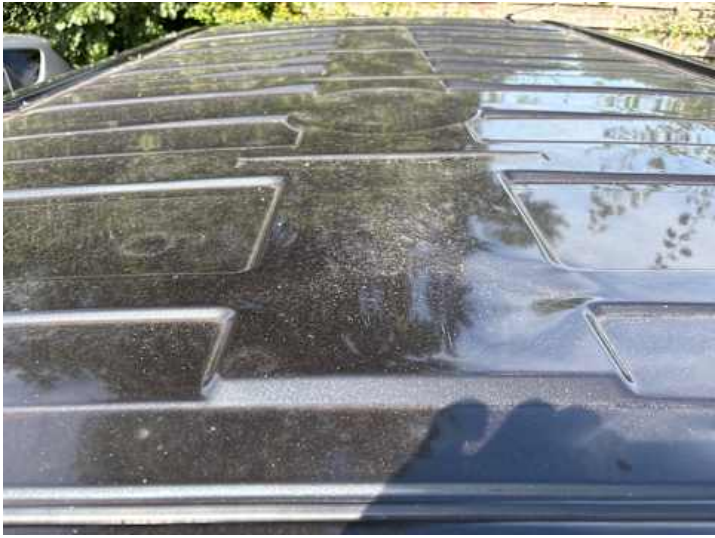
Dach (Verformung, Kratzer, Delle)
