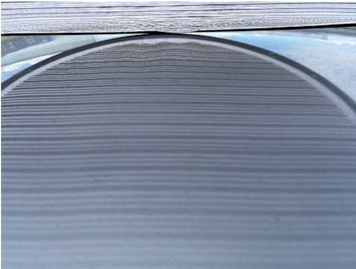
Dach (Steinschlag, Delle)
