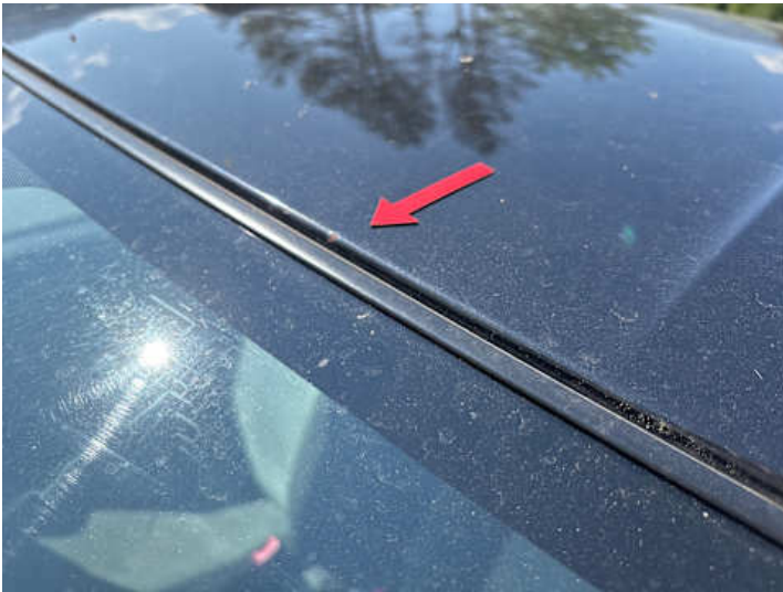
Dach (Steinschlag, Rost)
