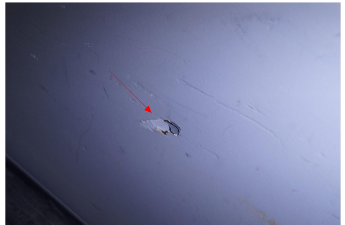
Bild 4: Innen, Verkleidung Schiebetür rechts, zerbrochen, erneuern
