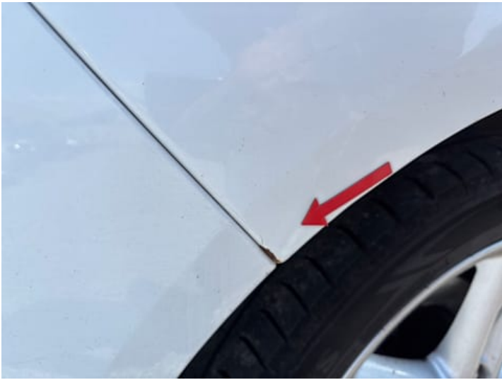
Seitenteil hinten rechts (Rost)
