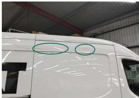
Tür / Oben Rechts / Delle
