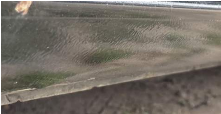
Schweller rechts (Verformung)
