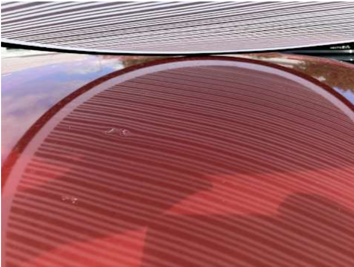
Dach (Delle, Anderer Schaden): Vandalismusschaden
