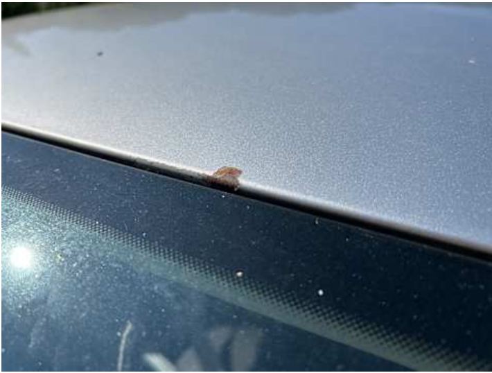
Dach (Lackschaden, Rost)
