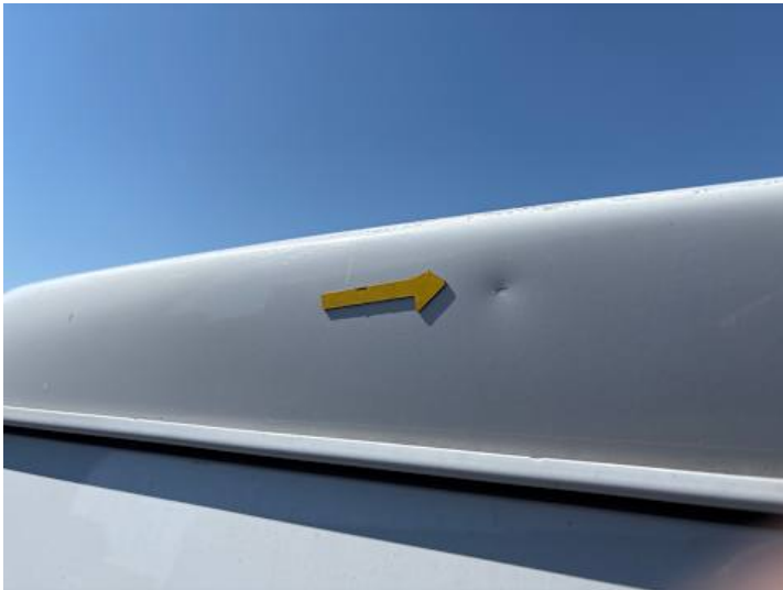
Dach (Delle, Kratzer)
