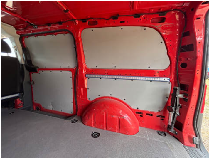
Innenraum (Verschmutzung, Verschleiß, Kratzer, Diverse Schäden, Riss/Bruch)
