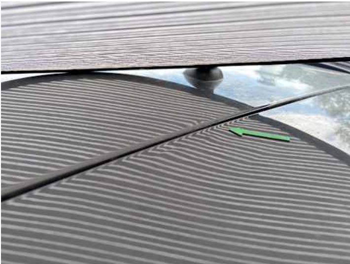
Dach (Kratzer, Verformung, Spaltmaße ungenau)
