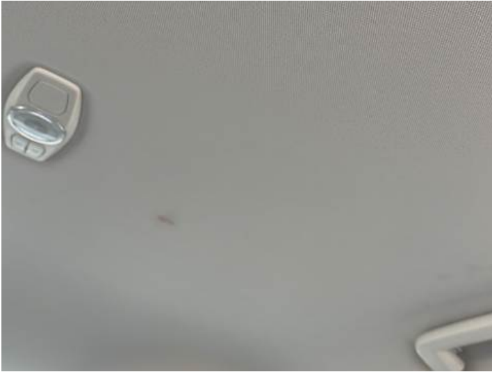
Innenraum (Riss/Bruch, Verschmutzung)
