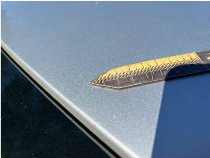
Dach (Steinschlag, Rost)
