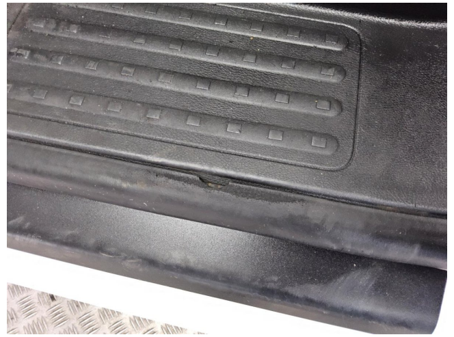
Türdichtung vorne links gerissen
