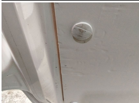
Innenverkleidung Laderaum / Hinten Rechts / Gebrochen
