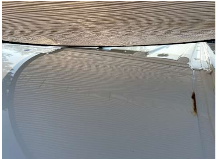
Dach (Verformung, Kratzer, Rost)
