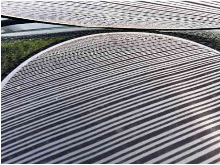
Dach (Lackschaden, Delle)
