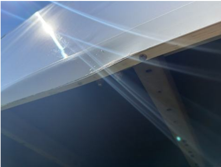
Schweller rechts (Verformung)
