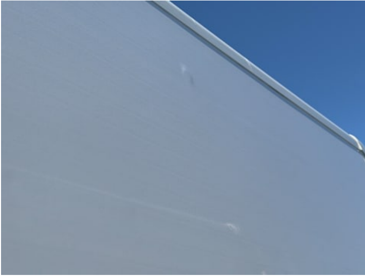
Seitenteil hinten rechts (Delle, Verformung)
