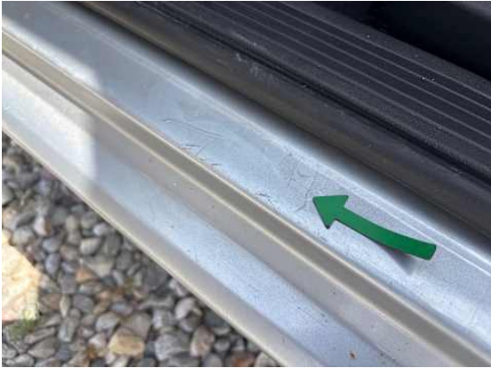
Schweller links (Kratzer, Rost)
