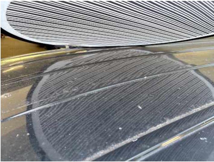
Dach (Delle, Verformung)
