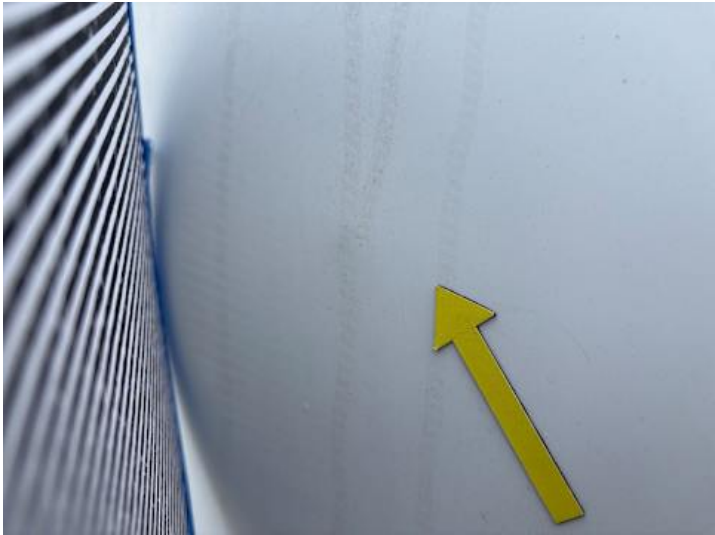
Seitenteil hinten links (Delle, Lackschaden, Rost)
