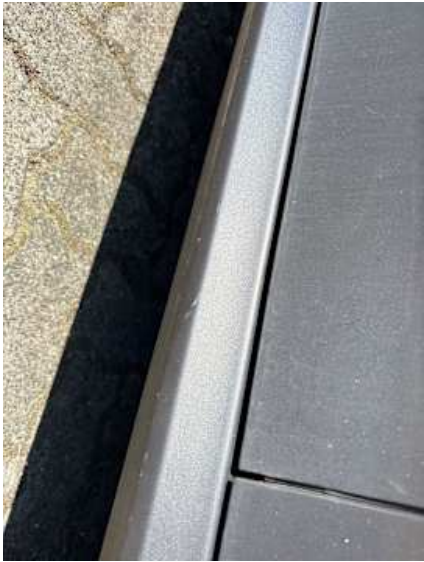
Schweller links (Kratzer)
