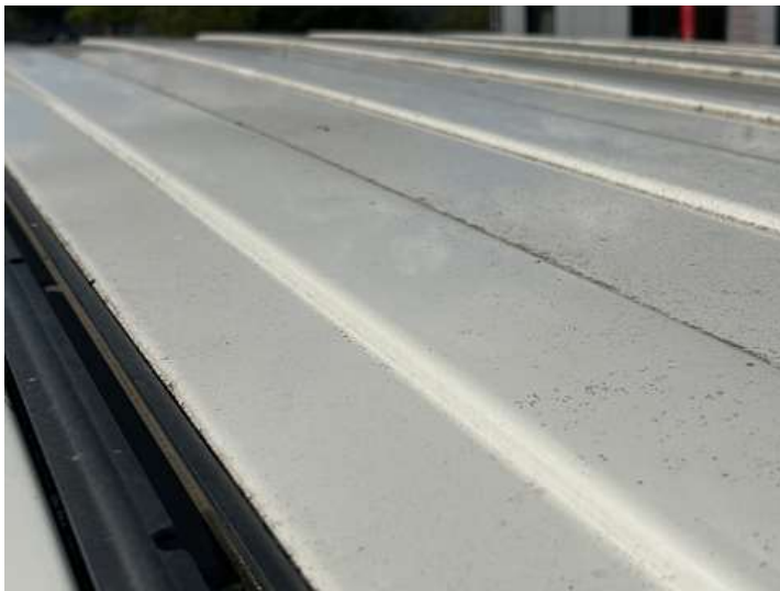
Dach (Delle, Lackschaden, Rost)
