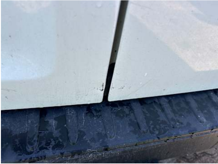
Heckklappe (Kratzer, Delle, Rost)
