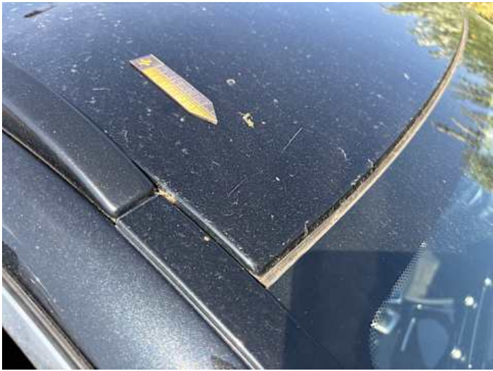
Dach (Kratzer, Steinschlag)
