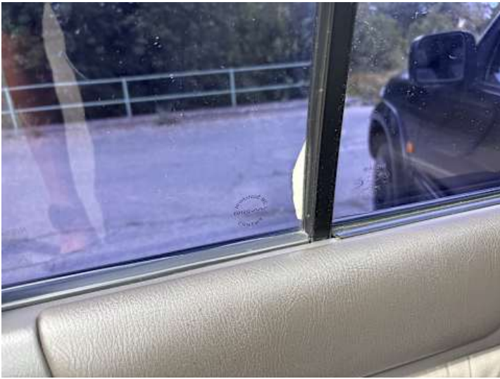
Türe hinten links (Unsachgemäß instand gesetzt)
