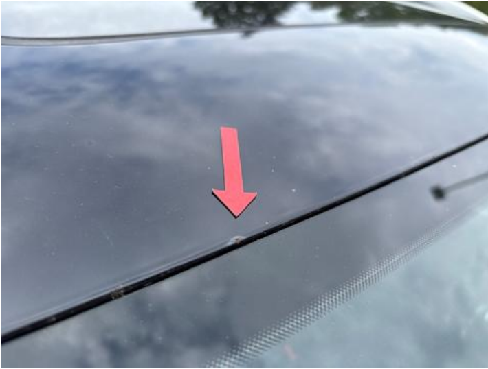
Dach (Rost, Lackschaden)
