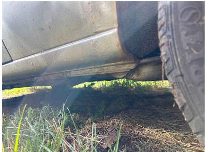
Schweller links (Rost)
