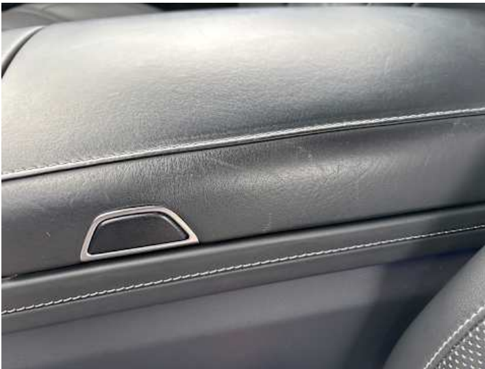
Innenraum (Verschmutzung, Verschleiß)
