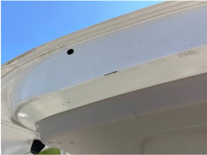
Heckklappe (Lackschaden, Kratzer)
