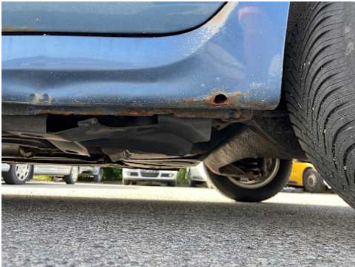
Schweller links (Rost)
