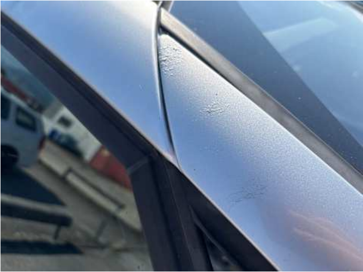
Seitenteil hinten rechts (Rost)
