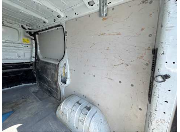
Innenraum (Diverse Schäden, Anderer Schaden, Verschmutzung): Korrosion
