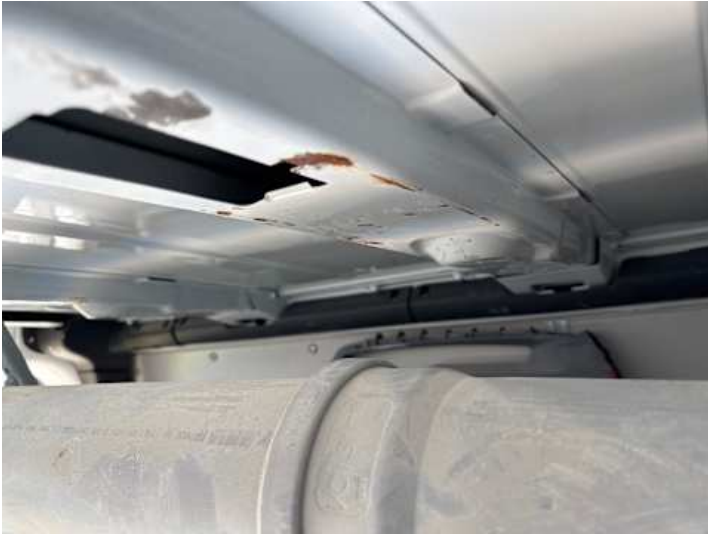
Innenraum (Diverse Schäden, Anderer Schaden, Verschmutzung): Korrosion
