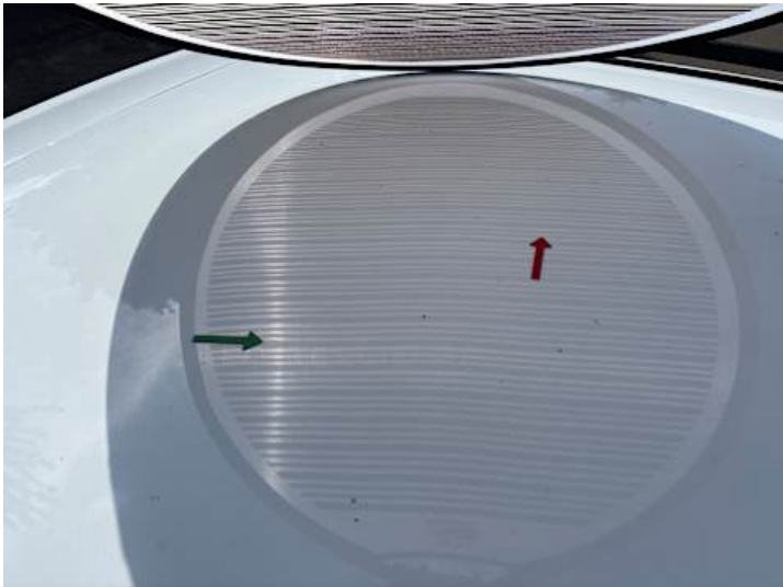
Dach (Delle, Steinschlag)
