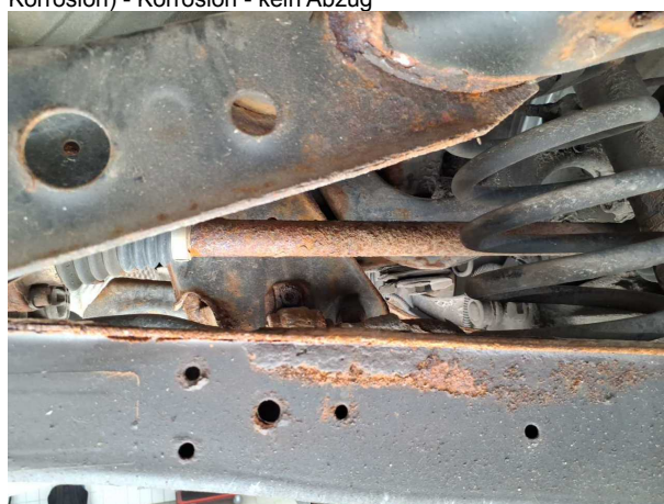
Gebrauchsspur 2: Hinterachse: Hinterachse (Hinweis auf Korrosion) - Korrosion - kein Abzug
