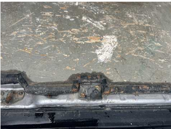
Innenraum (Verschleiß, Diverse Schäden)
