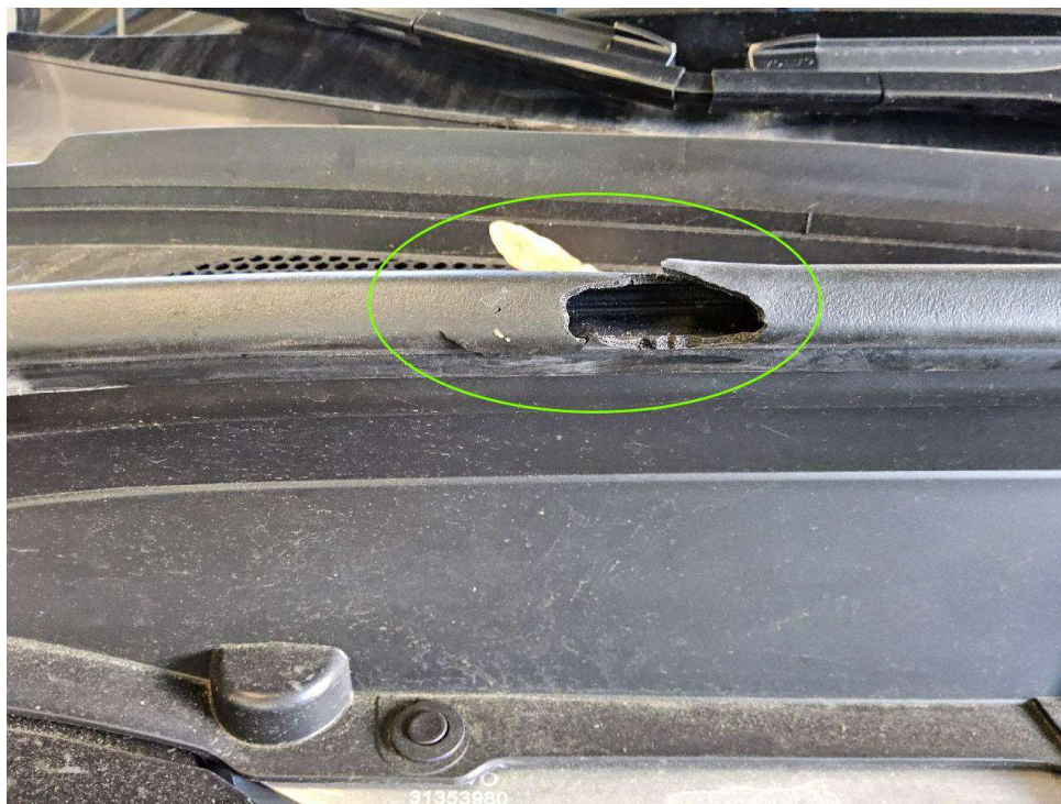
Bild 14 : Motorraum Dichtgummi Tierversiss (lag im Motorraum)
