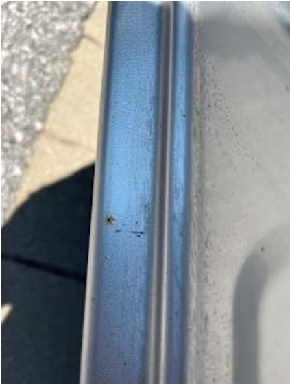
Schweller links (Rost)
